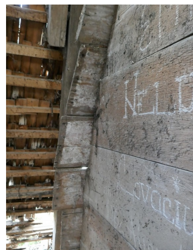
Urme de pictură pe capetele scândurilor bolții
